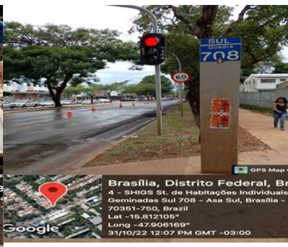
Execução de fresagem e retirada do pavimento existente na via W3 Sul.
